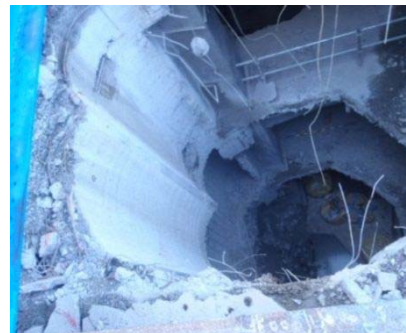
コアオール撤去 (カットダウン解体用高強度コンクリート柱)
