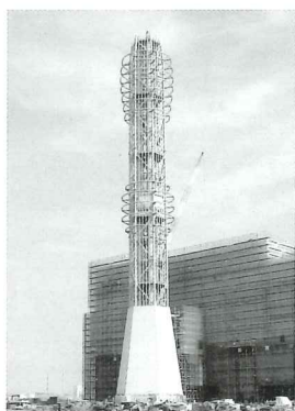
岸和田貝塚市クリーンセンター 100m煙突
